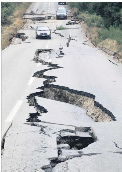
Las placas chocan, se comprimen y se liberan al igual que esta grieta que dejó el 27/F en Cañete.
